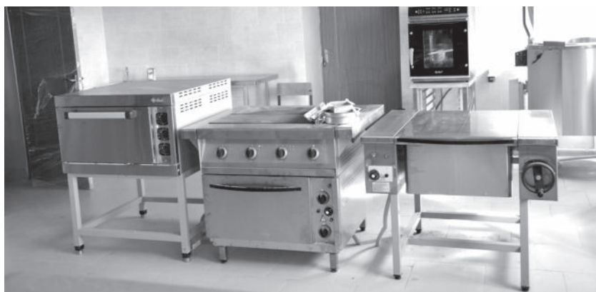
Помещение школьной столовой полностью готово и оснащено новым оборудованием
